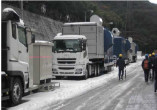
高台への電源車の配備（可搬式交流電源）
